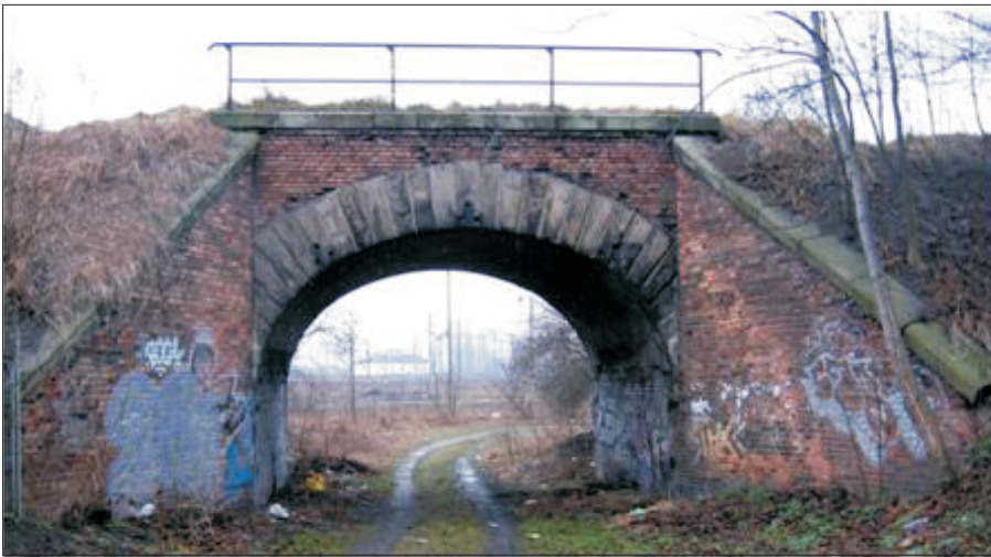
Rys. 1. Wiadukt sklepiony paraboliczny Drogi Żelaznej Warszawsko - Kaliskiej, stan obecny (fot. Konrad Duszczyk 2009)
