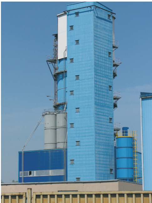
Rys. 1. Węzeł z instalacją do mechanicznego aktywowania popiołu lotnego, znajdujący się na terenie elektrociepłowni Jaworzno III Fig. 1. The installation used for the mechanical activation of siliceous fly ash in the heat and power plant Jaworzno III
