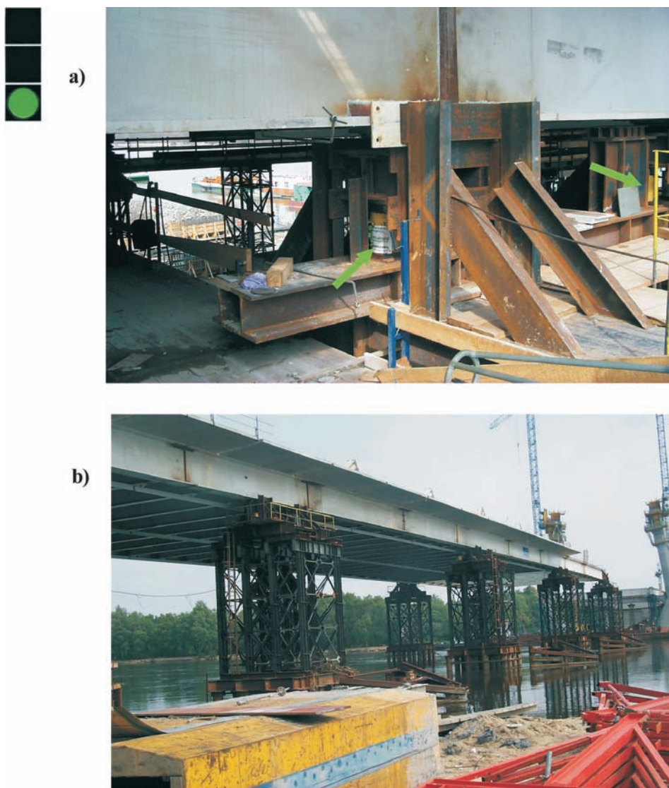
Rys.3. Kontrola reakcji na podporach; a) rozmieszczenie układu siłowników na podporze, b) widok nasuwanej konstrukcji
