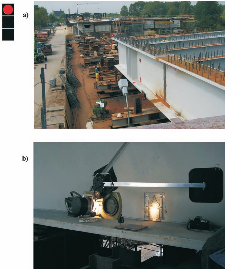
Rys.5. Pomiar stanu naprężeń: a) rozmieszczenie płytek elastooptycznych w przekroju nr 256 – widoczne 3 płytki w osłonach zamocowane na dźwigarze od strony górnej wody, b) widok 2 płytek - w osłonie i bez oraz polaryskopu do odczytu stany naprężeń
